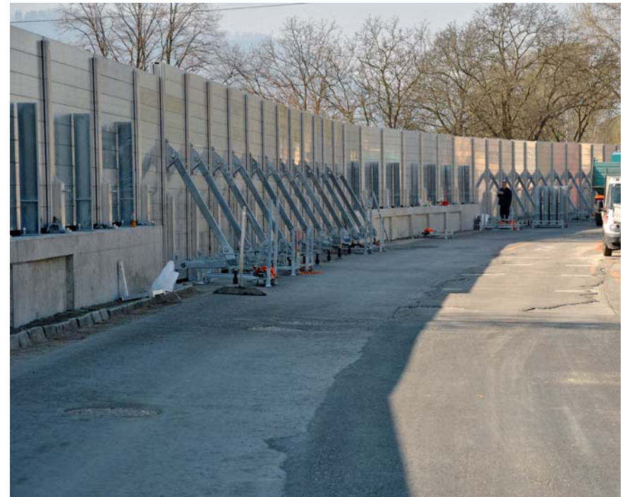
B3 Donau Straße, bodengleiche Elemente, Hochwasser 2013
