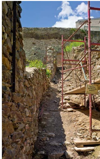
Stiegenaufgang zur Burg vor der Sanierung
